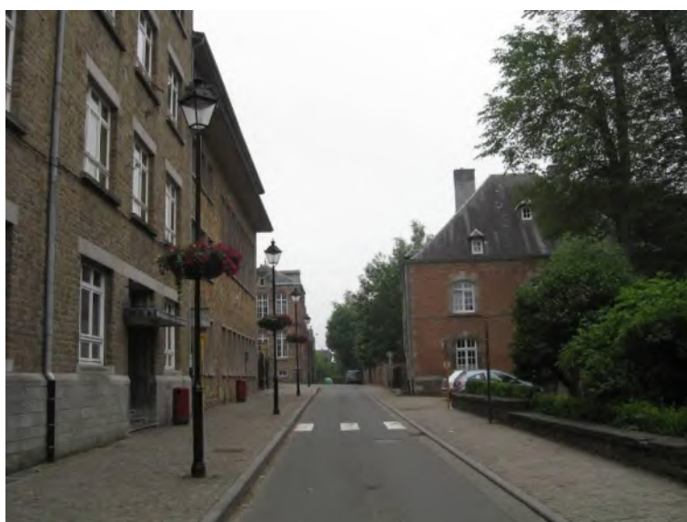
Luminaires existants de la rue des Prés
